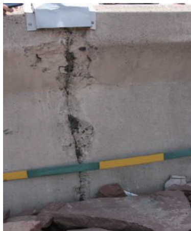
(b) 防浪墙接缝处压碎
