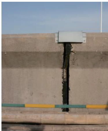
(a) 防浪墙接缝处拉开
